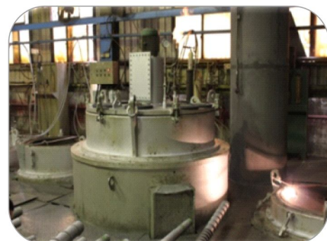
ガス窒化処理設備
